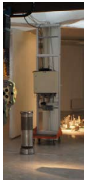
Styreskap inne i kokongen.
